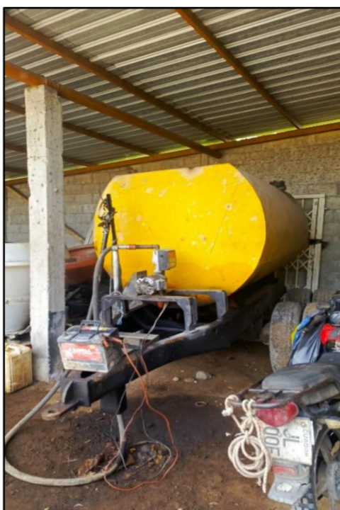
Figura 8: Tanque Móvil De Almacenamiento De Combustible
