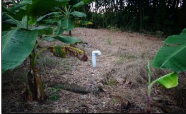
Figura 22: Pozo Séptico de uno de los campamentos.
