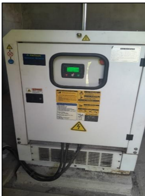
Figura 9: Generador Eléctrico de Emergencia.
